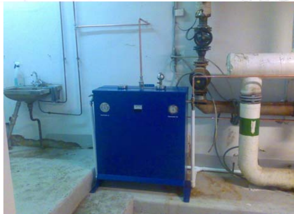
Sistema CAS instalado en circuito de una Caldera
