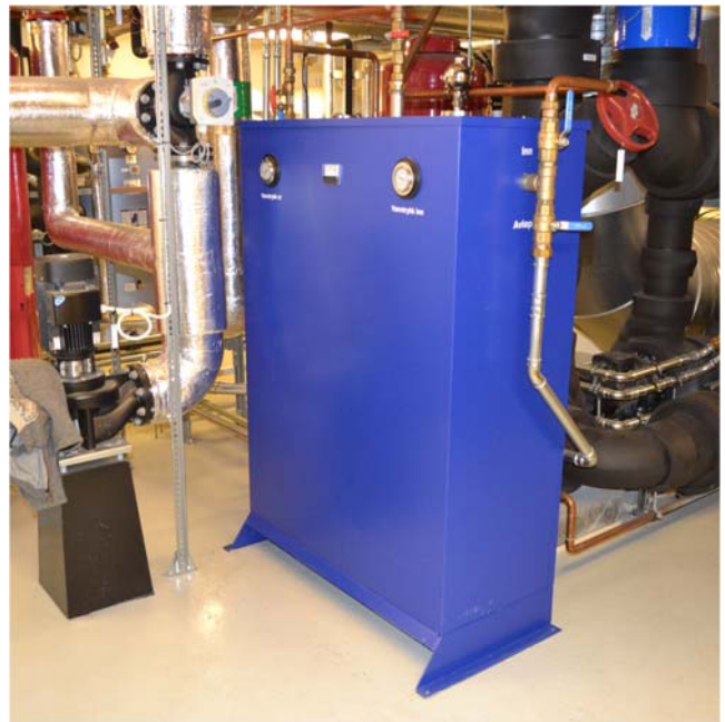
Tecnología de Eficiencia Energética; sistema C4S-80 instalado en un edificio de 63.000 m2 (4 sistemas en total—1 para cada circuito)
